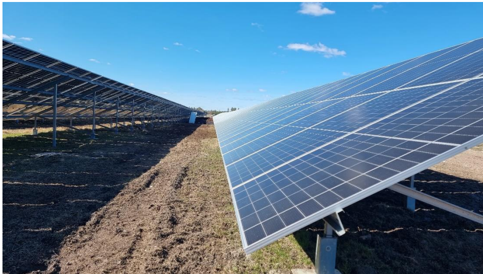
Figur 6 - Solceller montert i portrett. Kilde: Helios Nordic Energy AB
